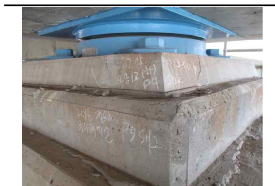
교각 받침장치 (P9) 무수축물탈 파손 (0.3 × 0.4)
