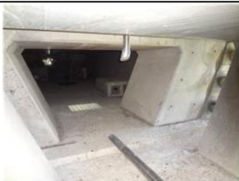
배수시설 (S6-1) 배수관 탈락
