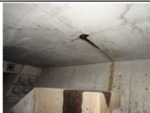
배수시설 (S6-1) 배수관 미설치
