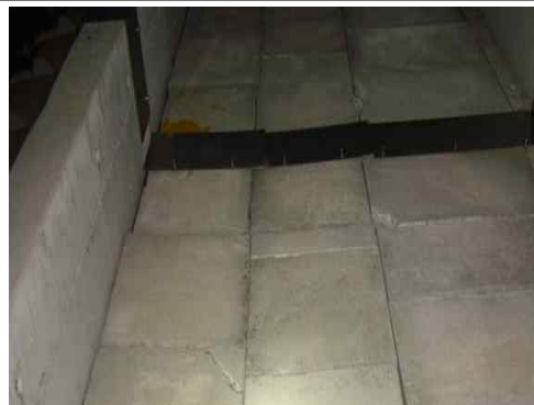
신축이음 상태 양호
