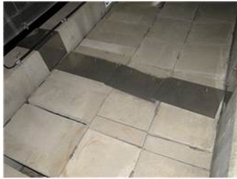
신축이음 상태 양호
