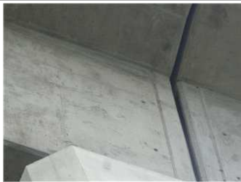
신축이음 상태 양호
